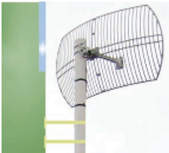
Figura 10. Montaje de la antena en Facultad de Ingeniería
